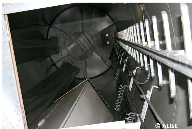
Photo 49 : Intérieur du mât d'une éolienne (échelle d'accès)
