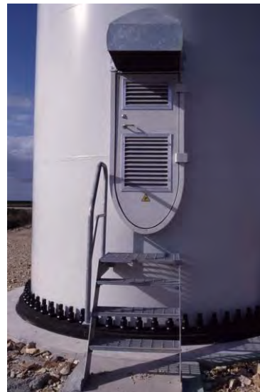
Photo 52 : Transformateur électrique intégré au mât de l'éolienne
